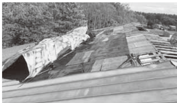
屋根が剥がされた土幌高校体育館
