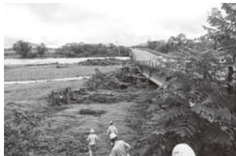
川底がえぐられ落橋した西上橋
