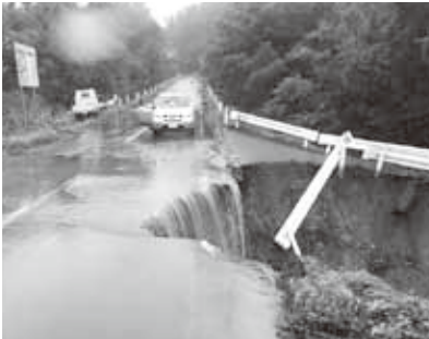
崩落した町道士幌14線
