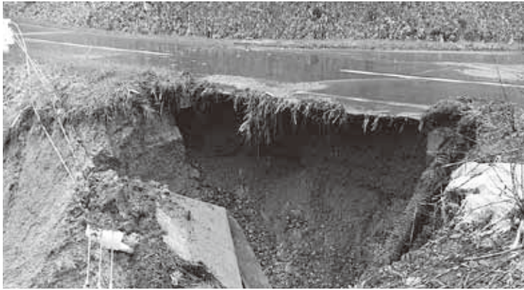
5月の大雨による路肩洗掘被害（開運地区）
