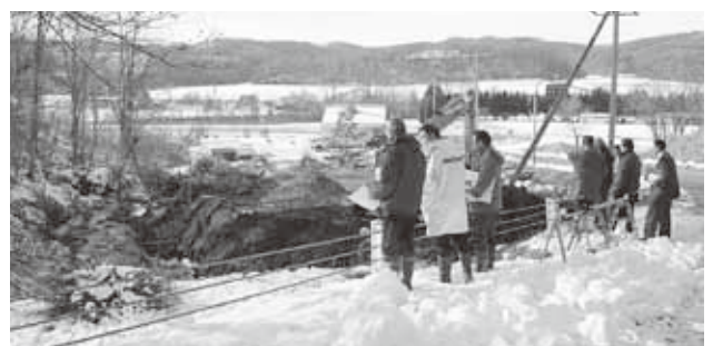
西上地区の災害箇所調査
