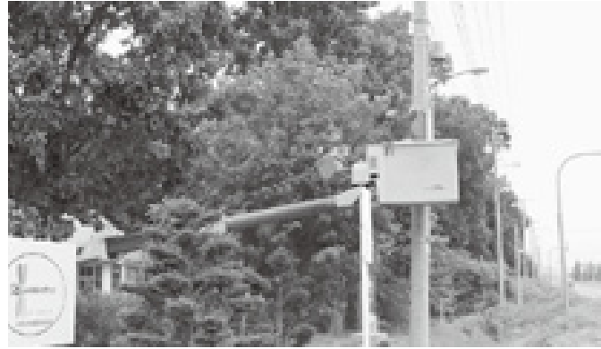
LED化される防犯灯
