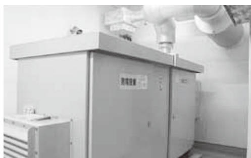
国保病院の非常用発電装置
