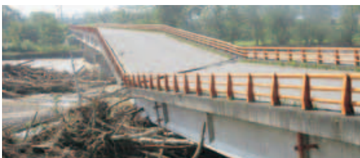
橋脚（基礎部分）が洗掘され、沈む西上橋
