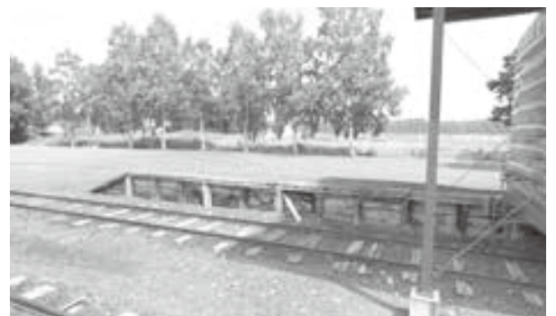
老朽化したプラットフォーム
