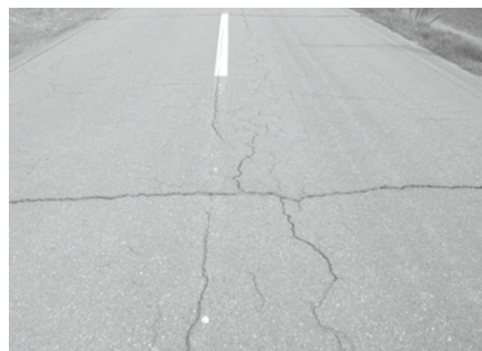
舗装道路に見られる「横断クラック」
