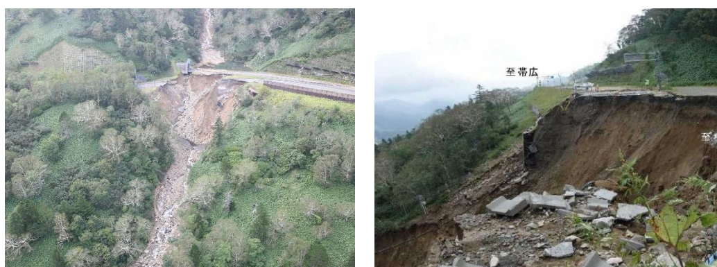
写真 1-3 日勝峠の被害状況（2016年台風10号）
