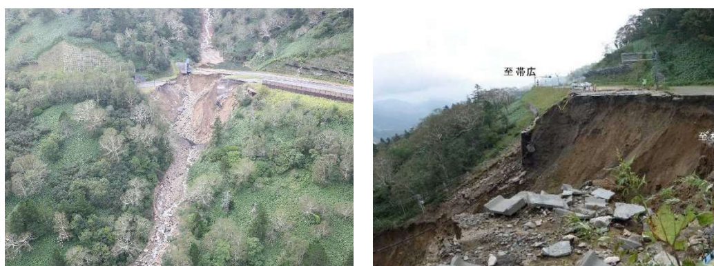
写真 2-3 日勝峠の被害状況（2016 年台風 10 号）
