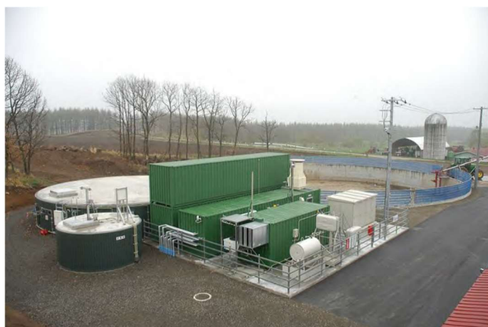
写真 4-1 士幌町におけるバイオガスプラント
