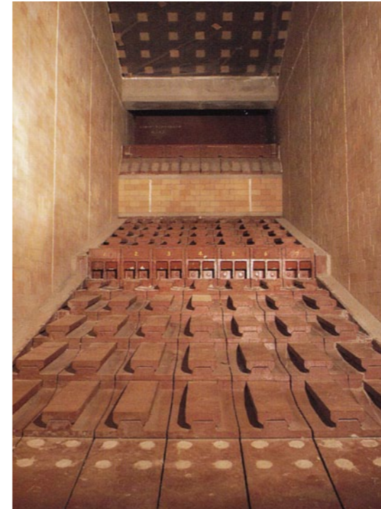
● 焼却炉ストーカ しょうきゃくろ 下から空気を吹き込み、ごみをかくはんしながら燃やします。
