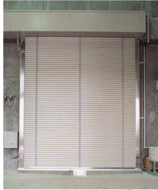
● プラットフォーム及びごみ投入扉 とびら ここからピットへごみを投入します。
