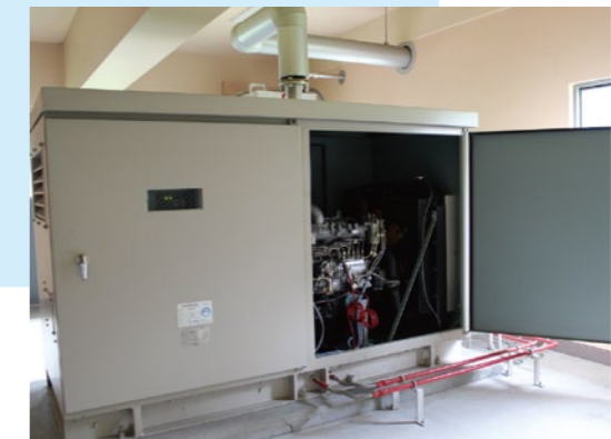
発電室(発電機)
