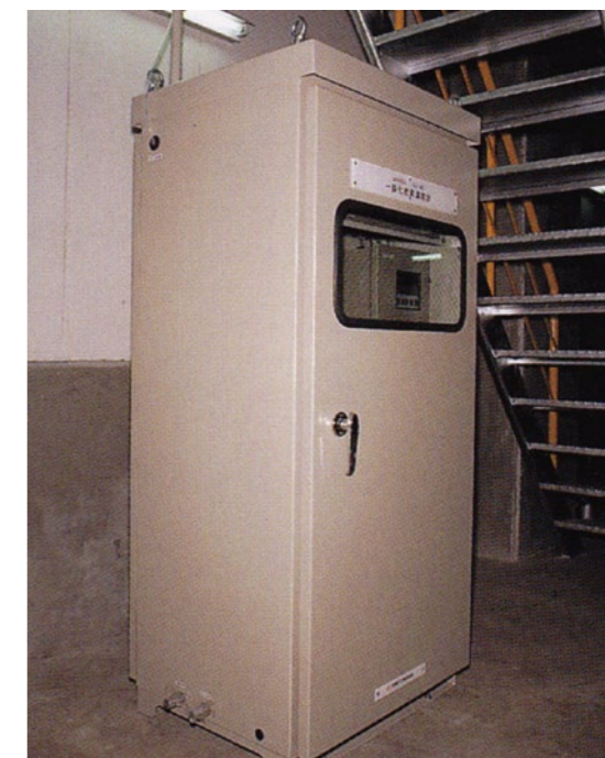
●一酸化炭素濃度計 ごみが完全燃焼しているかどうかチェックする装置です。
