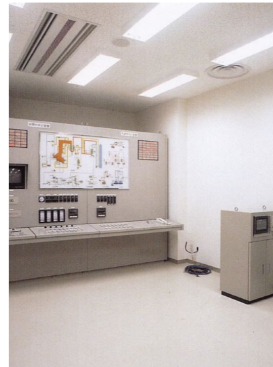
● 管理制御室 かんりせいぎよしつ ここで、ごみ焼却場内の各機器を集中監視・制御します。
