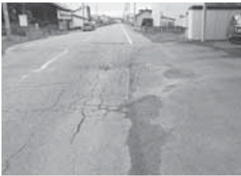
凍結等で傷んだ簡易舗装道路
