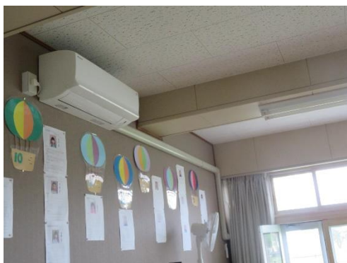
「各教室に設置されたエアコン」
